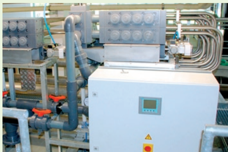
Molchschleusen und die Steuerungseinheit
